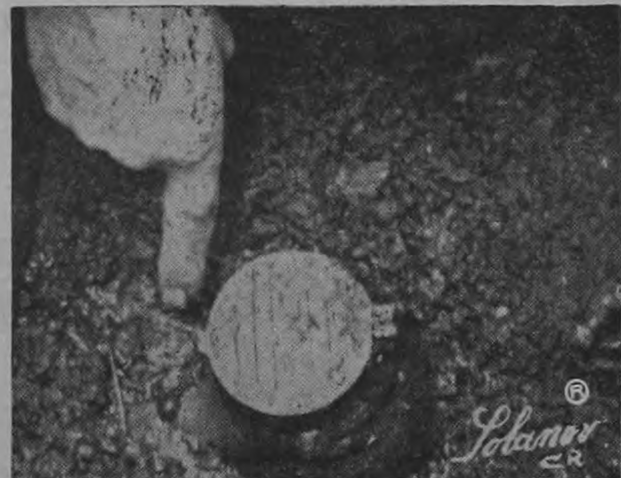
ESTE MEDIDOR ESCAPA AGUA constantemente. Perteneció al servicio de Benjamín Calvo Solís. Dice que lo ha reportado personal y telefónicamente. Nadie lo arregla y le cargan lo que bota el medidor...
